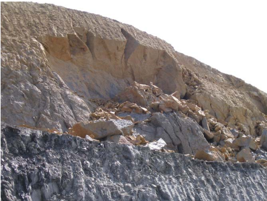
Slika 3. Oštećenja kosine izazvana nepravovremenim izvođenjem zaštite
