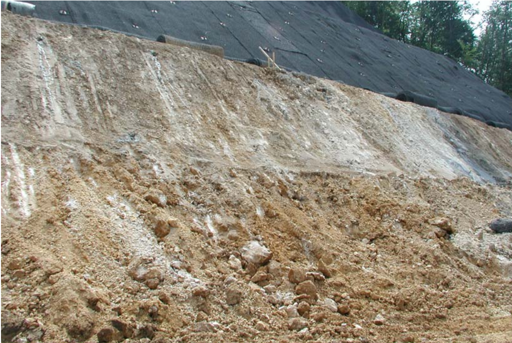
Slika 2. Gotovo nevezan materijal u iskopu na kosini usjeka
